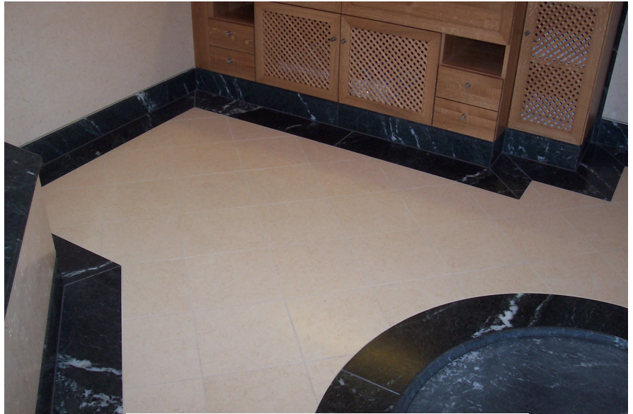
Nassraum mit Elektro-Fußbodenheizung
